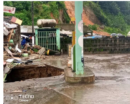
Après l'effondrement à Droite.
