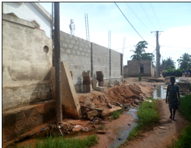
Photo n° 2 : Dégât de l'érosion sur la clôture d'une habitation
