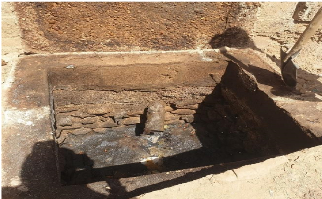
Photo 1 : fosse remplie des eaux usées et de boue dans le quartier Yadakondagué
