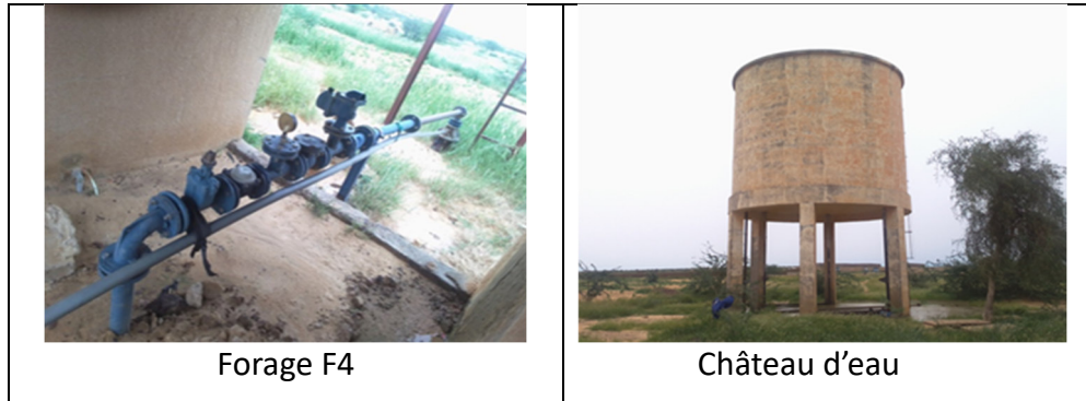
Photo 1 : Forages et château d'eau de Tanout
