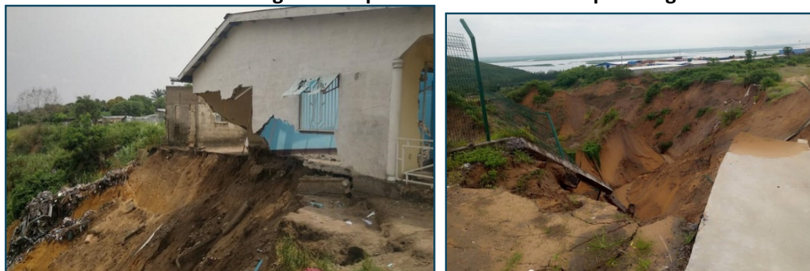
Photo 1 et 2 : Dégât causé par l'érosion suite à des pluies agressives
